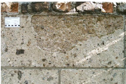
Abb. 3: Berlin, Kaiser-Wilhelm-Gedächtnis-kirche, schalenförmige Ablösung am Ettringer Tuffstein in Folge einer Hydrophobierung aus dem Jahr 1982. Die Dicke der Schale korreliert entsprechend einem Untersuchungsbericht der Bundesanstalt für Materialforschung und -prüfung (Forschungsbericht 0215-7.15-0510 / 7517) der Eindringtiefe des Hydrophobierungsmittels. (Photo: Y.Rieffel, 2011).
