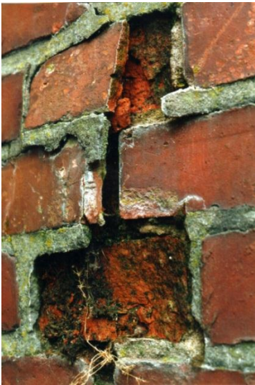
Abb. 5: Abgeplatzte Ziegeloberflächen eines hydrophobierten Mauerwerks. Die Dicke der Abplatzungen entspricht der Wirtiefe des Hydrophobierungsmittels. Darunter ist das Mauerwerk wassergesättigt (Algenwachstum) (Photo: MPA Bremen).
