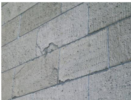
Abb. 2a/b: Vorgehängte Fassade aus Wieberner Tuff (Aachen, Verwaltungsbau, 1920er Jahre); 1986 erneuert und hydrophobiert. In Folge zeigt sich eine nahezu flächige Schalenbildung und ein sehr fleckiges Erscheinungsbild nach Regenfällen. Die hydrophobe Oberfläche bleibt dann trocken und der nicht hydrophobe Kern im Bereich bereits abgefallener Schalen ist nass. (Photo: VDL, AG Restaurierung/Material-kunde).
