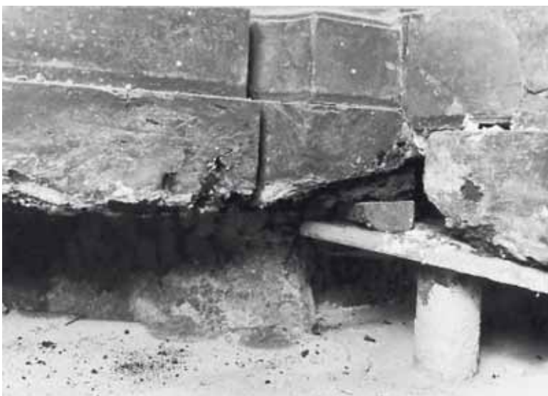
Abb. 43. Feuchtigkeitsschäden an einem Stuckmarmoraltar
