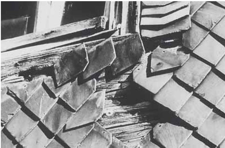
Abb. 18. Schadstelle in einer Schieferverkleidung
