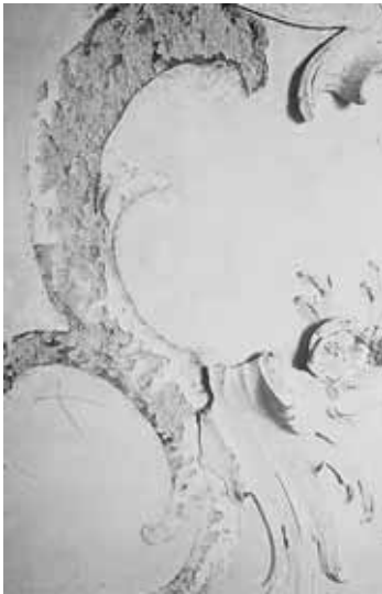
Abb. 26. Fehlstelle in der Stuckierung
