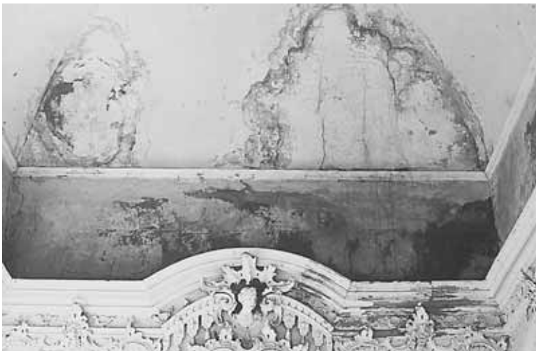
Abb. 28. Wasserschaden im Gewölbe durch Schäden in der Dachdeckung
