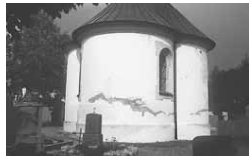
Abb. 19. Markanter Feuchtigkeitshorizont, verursacht durch einen diffusionsdichten Sperrputz im Sockelbereich
