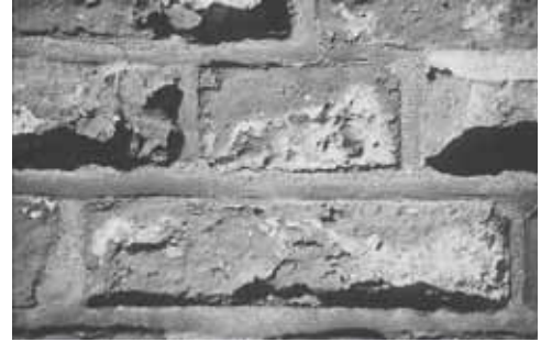
Abb. 17. Ziegelsteine verwittern, die Zementverfugung nicht
