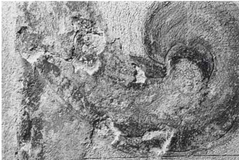
Abb. 22. Putzschäden, Abplatzungen an einer Fassadenmalerei
