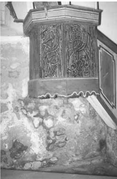
Abb. 31. Durchfeuchtung der Wand mit Algenbewuchs im Sockelbereich
