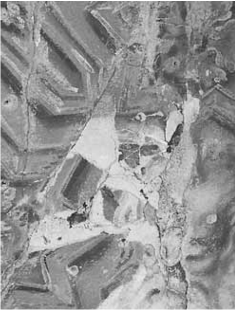
Abb. 29. Ausbrüche im Deckengemälde
