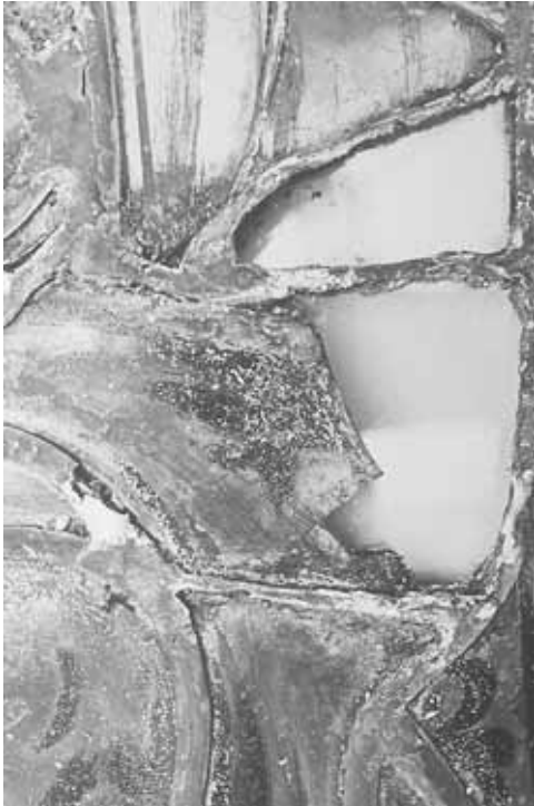
Abb. 20. Fehlende Scheiben in einem Glasfenster
