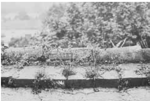
Abb. 14. Bewuchs schadet dem Mauerwerk
