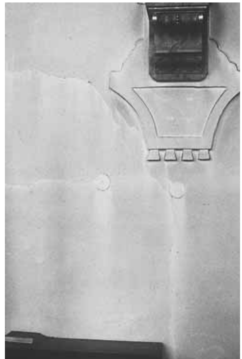
Abb. 32. Schmutzfahnen an der Wand durch falsches Beheizen
