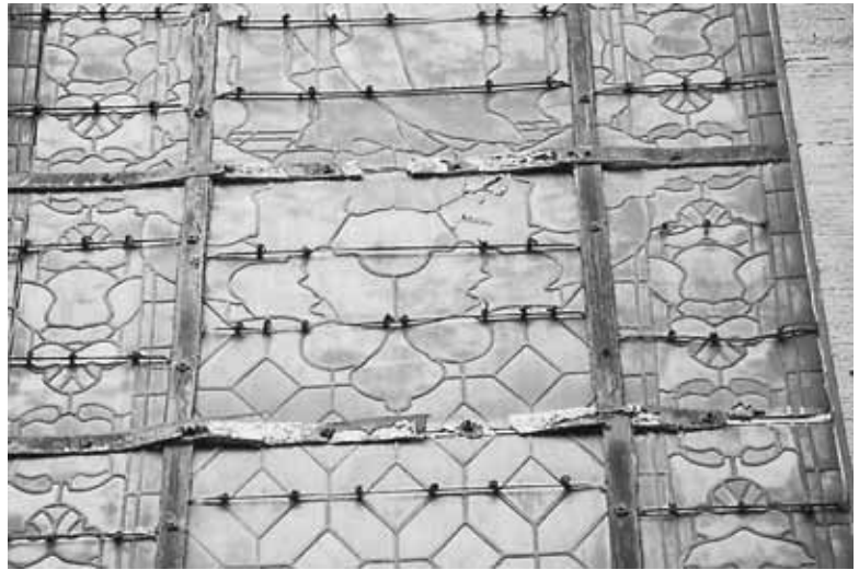
Abb. 21. Verrostete Windeisen eines Glasfensters
