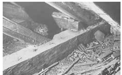
Abb. 24. Holzabfälle und ein vermoderter Binderbalken: Nährböden für Holzschädlinge
