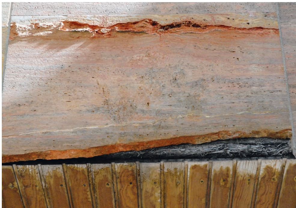
Bremen, Staatsarchiv, Schäden am Travertin
