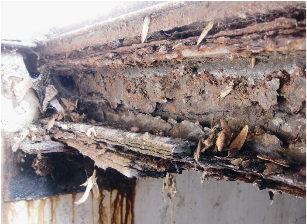
Bremen, Staatsarchiv, Vorhangsfassade, Schadensbild
