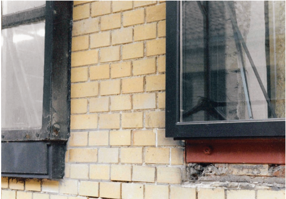
Alfeld, Fagus-Werke, erneuerte Fenster an einem Welterbe
